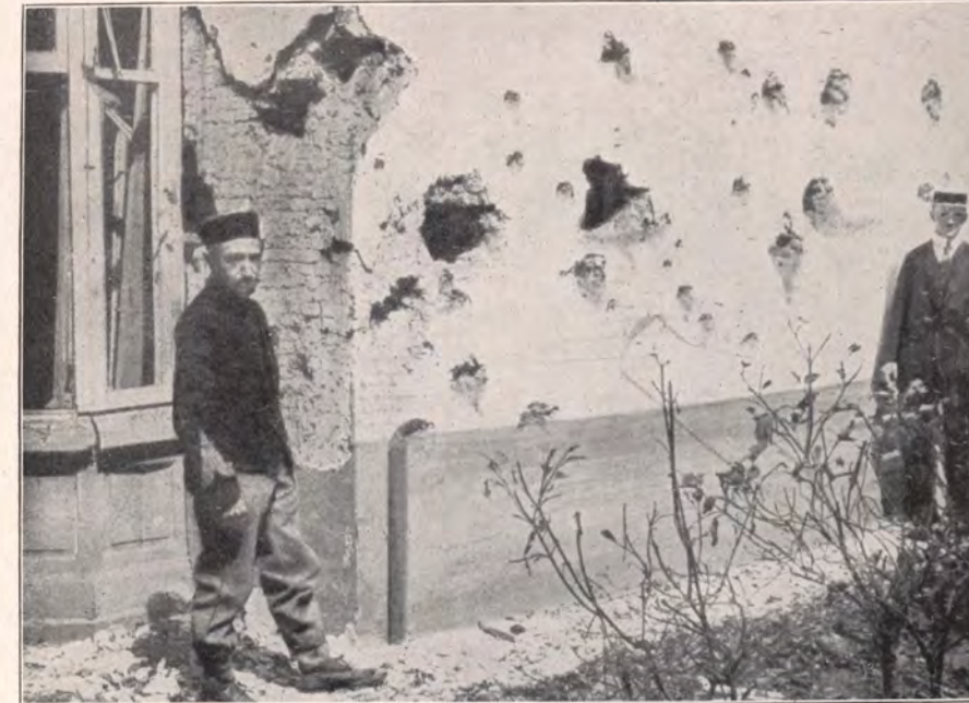
Eine durchlöcherter Hauswand.
